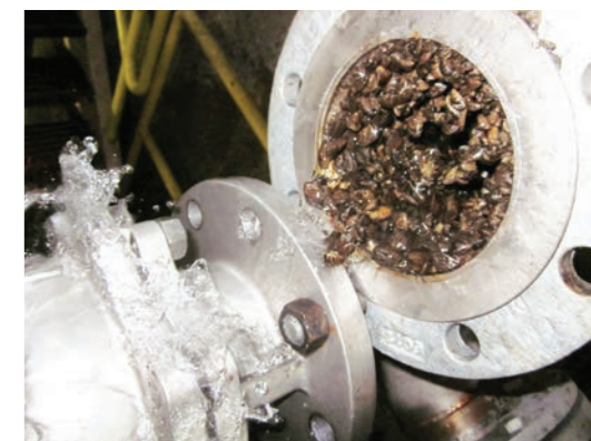
Рис. 1. Результат биологического обрастания трубопровода забортной воды
